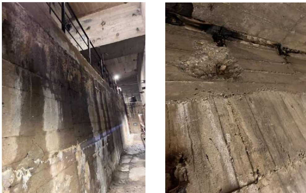
Рисунок 2 - Дефекты железобетонных конструкций забральной балки
