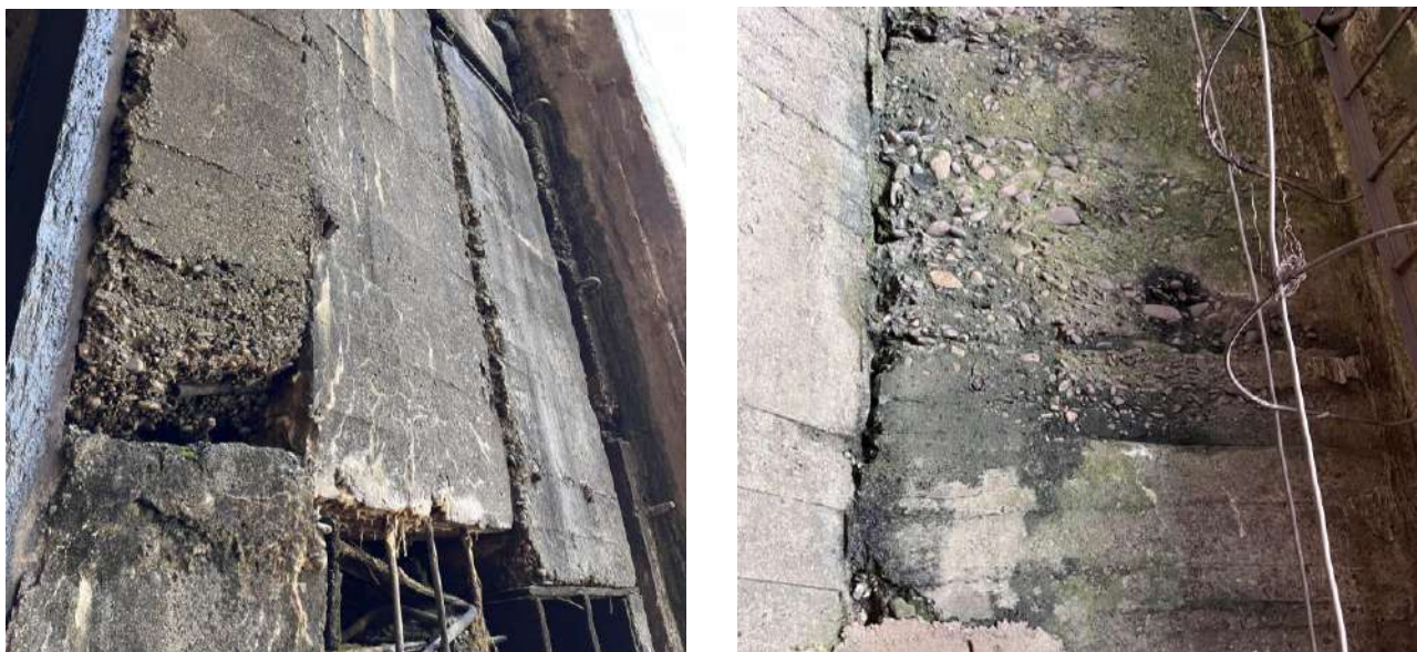
Рисунок 1 - Дефекты штрабного бетона основных ворот шлюза
