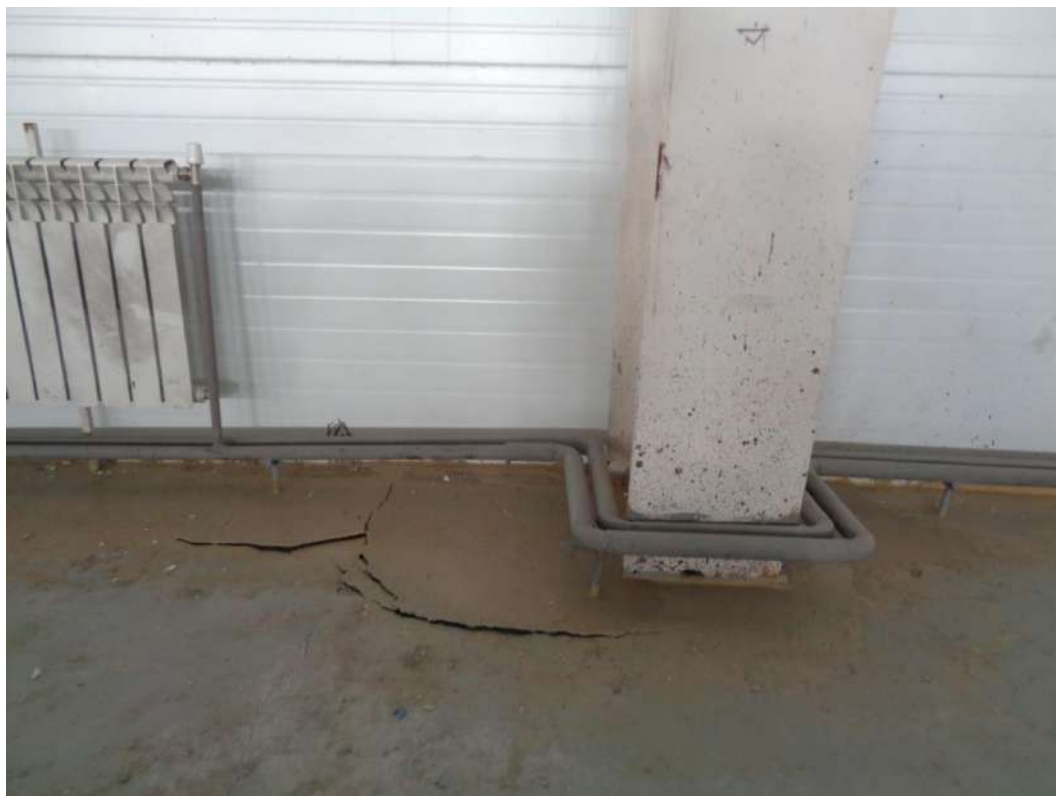
Рисунок 1 – Просадка пола вокруг верхнего обреза фундамента под колонну
