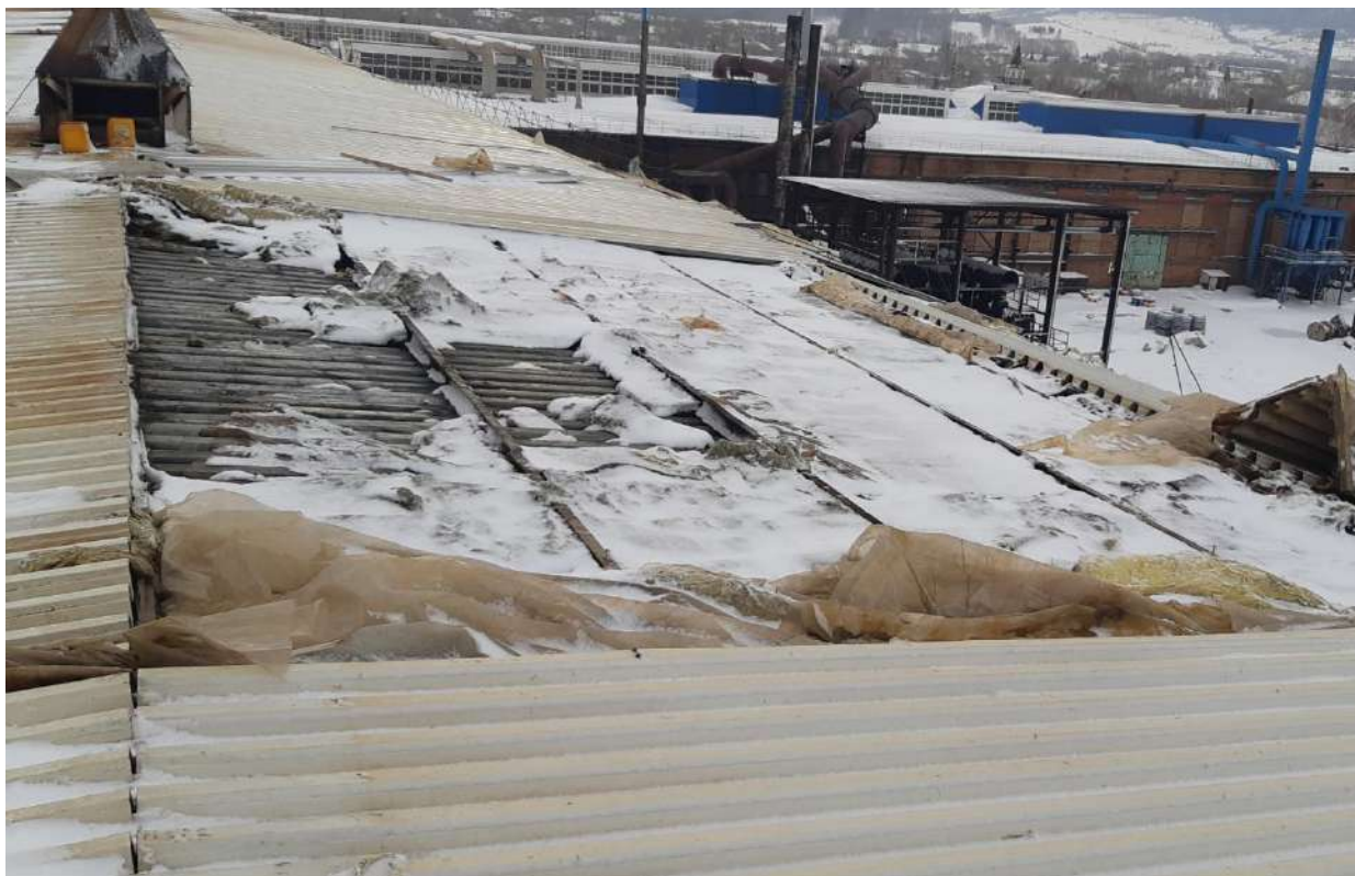
Рисунок 2 – Поврежденный участок кровли
