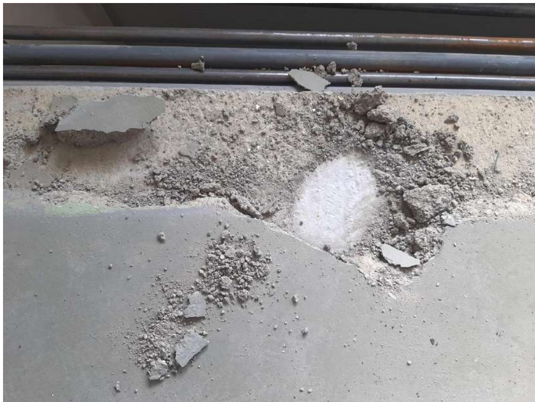
Рисунок 2 – Цементная стяжка рабочей площадки имеет низкую прочность, которая приборами неразрушающего контроля не определяется
