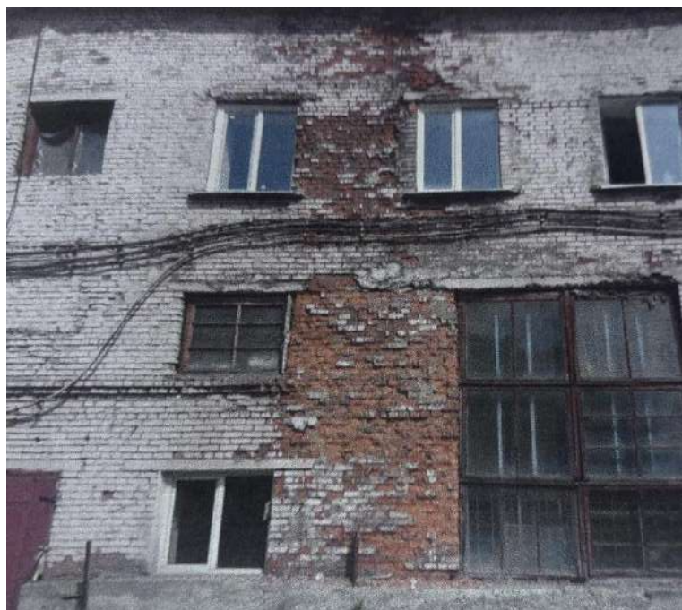
Рисунок 1 – Разрушение кирпичной кладки
