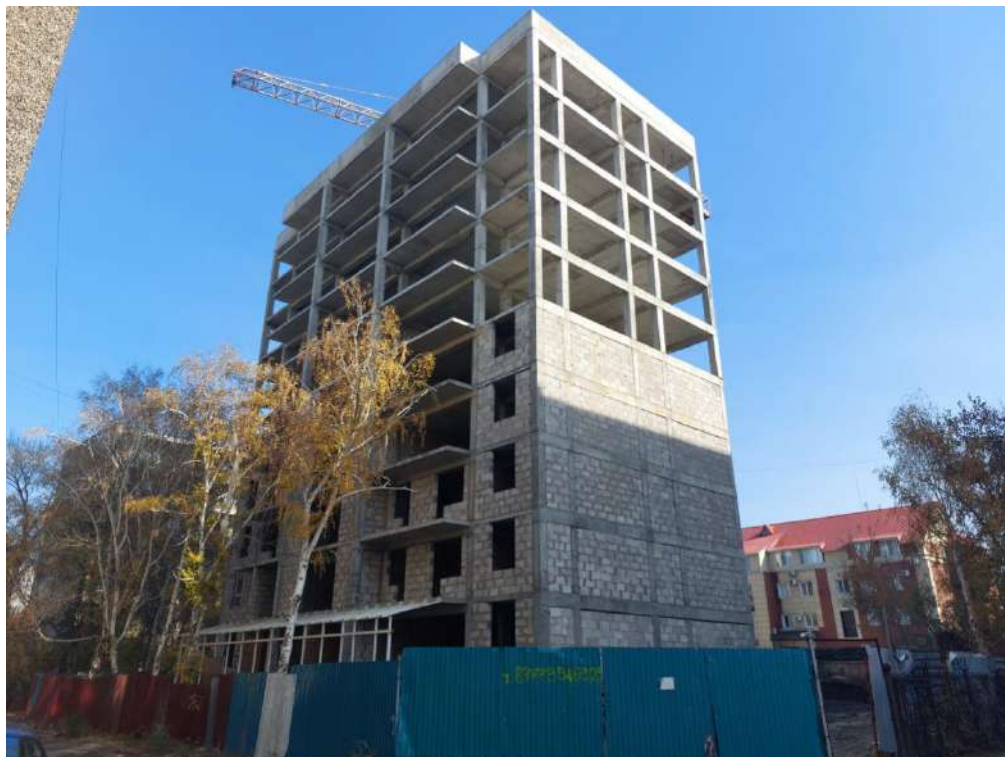
Рисунок 1 – Общий вид недостроенного жилого дома
