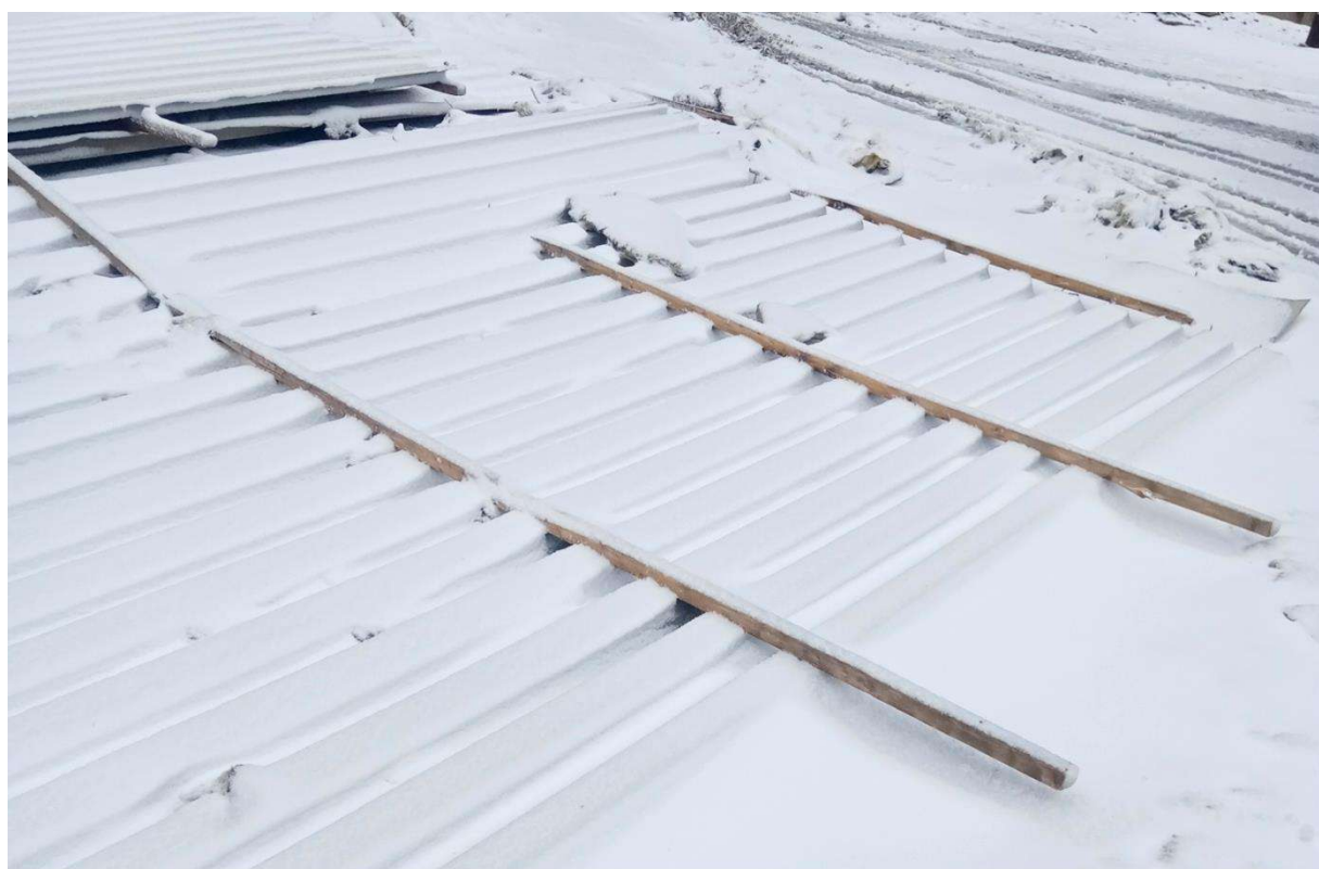
Рисунок 3 – Оторванные кровельные листы вместе с деревянными брусками лежат на земле
