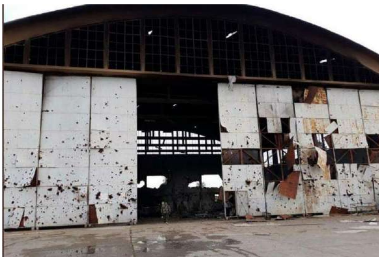
Рисунок -2 Конструкции здания ангарного типа после огневого воздействия (пожара)
