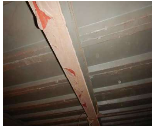
Рисунок 2. Коррозия металлических элементов конструкций
