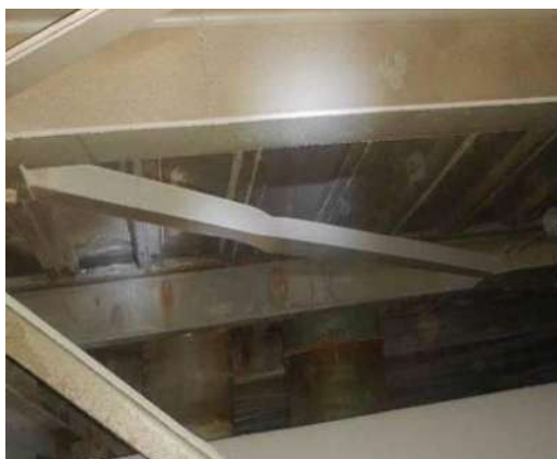
Рисунок 3. Деформации отдельных элементов покрытия
