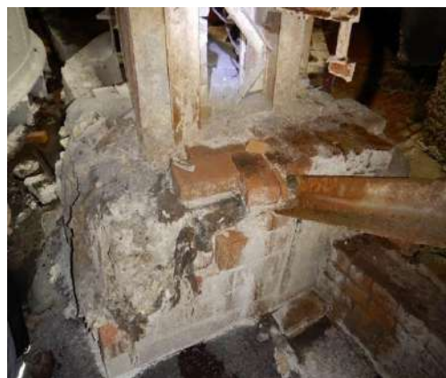
Рисунок 4. Повреждения полов и отдельных участков фундаментов
