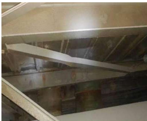
Рисунок 3. Деформации отдельных элементов покрытия
