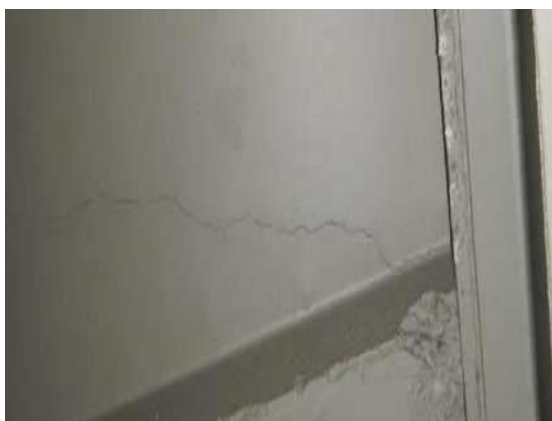
Рисунок 1. Трещины в железобетонных элементах
