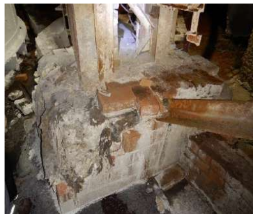
Рисунок 4. Повреждения полов и отдельных участков фундаментов
