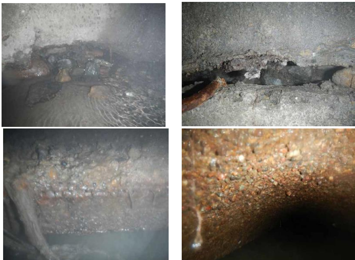
Рисунок 1 – Скопление отложений и вид оголенной арматуры коллектора
